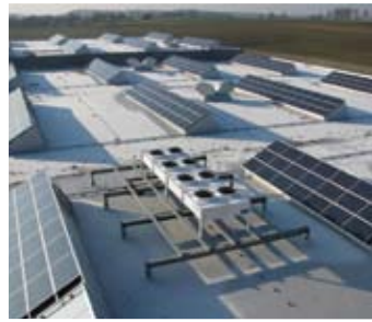
Von links nach rechts: Heizungsraum mit Wärmepumpe, Druckluftanlage mit Wärmerückgewinnung, Photovoltaik-Anlage und Rückkühler zum Abführen überschüssiger Wärme.
