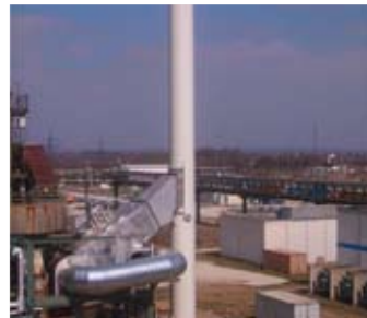
Von links nach rechts: Corporate Center der Evonik Industries AG in Essen, Umsetzung der beschlossenen Maßnahmen im Team, Rauchgaskamin in der thermischen Nachverbrennung mit vorgeschaltetem Wärmetauscher zur Vorwärmung des Kesselspeisewassers.
