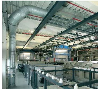
von links nach rechts: 50 kW Brennwert-Blockheizkraftwerk, Kompressorenabwärme zur Beheizung der Galvanik, über die Lüftungsanlage zugeführte Abwärme zur Beheizung der Wäscherei und Tauchgalvanik.
