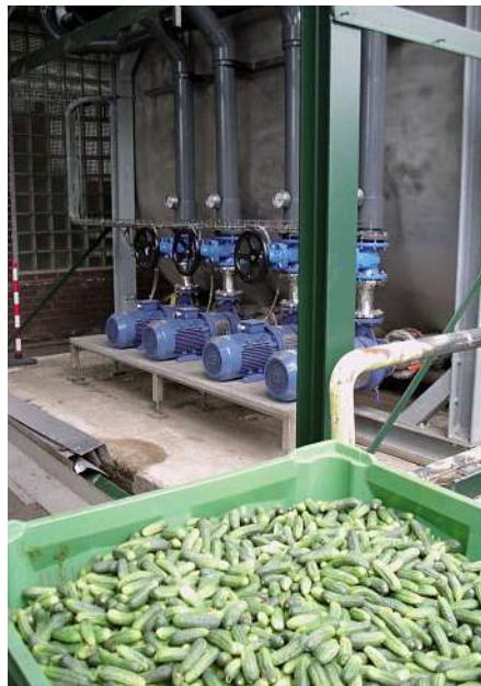
Bild 3: Neue Anlage ohne Rückschlagklappen und mit voll geöffneten Absperrschiebern
