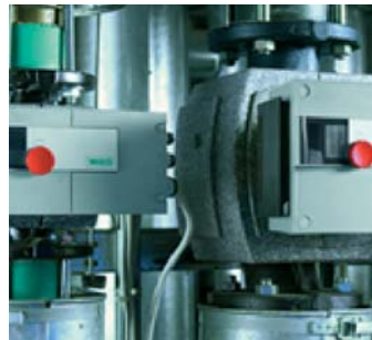
Von links nach rechts: Umwälzpumpen bei der Infracor GmbH, Chemiepark Marl, WILO Stratos Pumpen in der Heizzentrale
