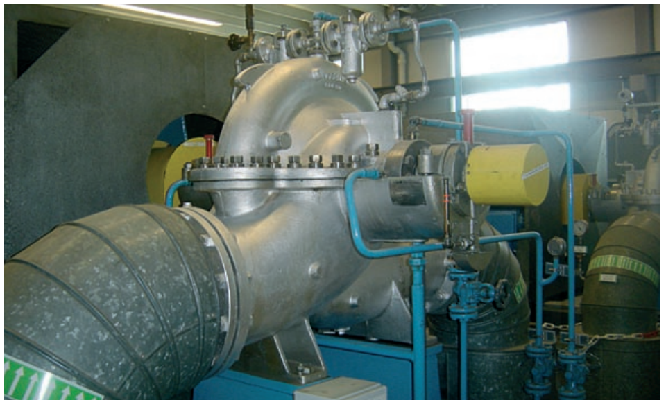
Eine Umwälzpumpe bei der Fernwärme Ulm GmbH zur Versorgung des Fernwärmenetzes des Industriegebiets Ulm-Donautal.
