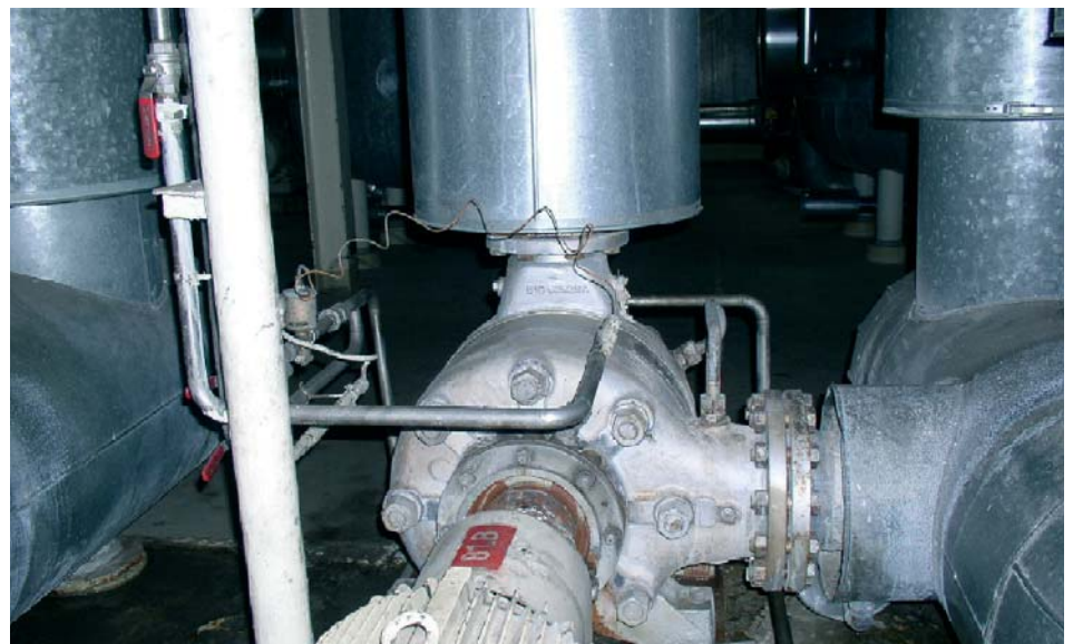
Alte Heißwassernetzpumpen mit Stopfbuchskühlung bei der Binding Henninger Brauerei.
