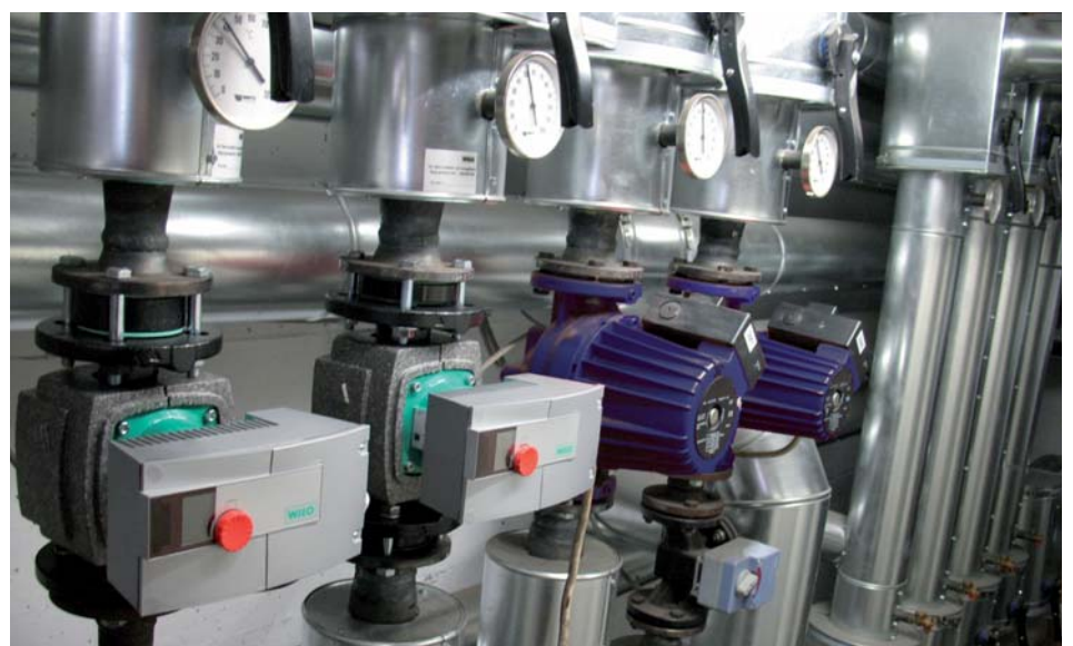
Heizungsverteiler bei der Foseco GmbH.
