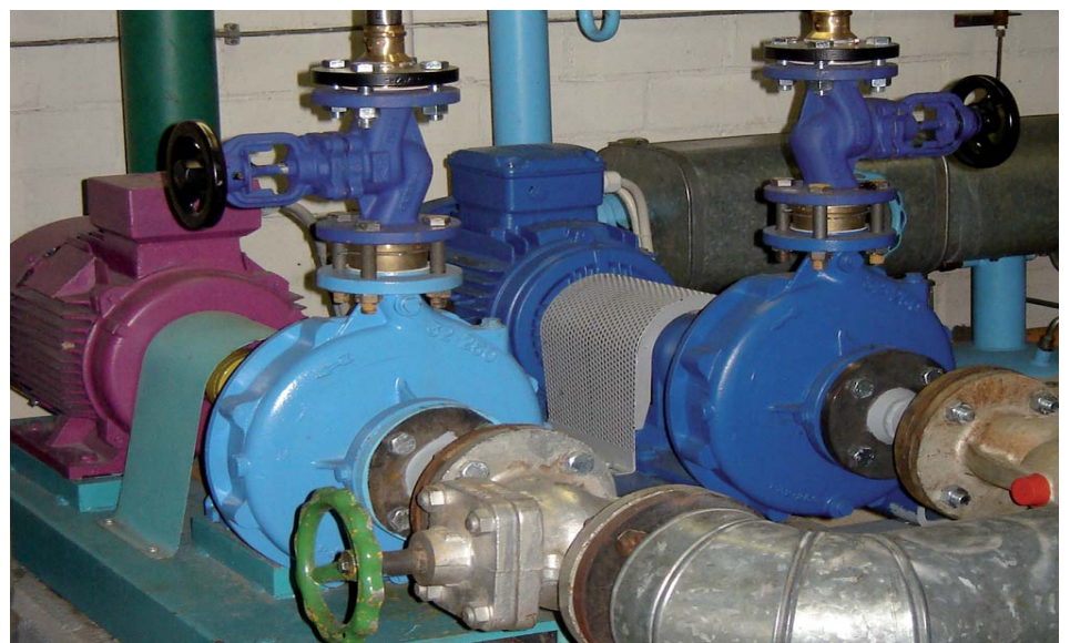
Pumpensysteme der Rummelsberger Baubetreuungs- und Dienstleistungsgesellschaft mbH.
