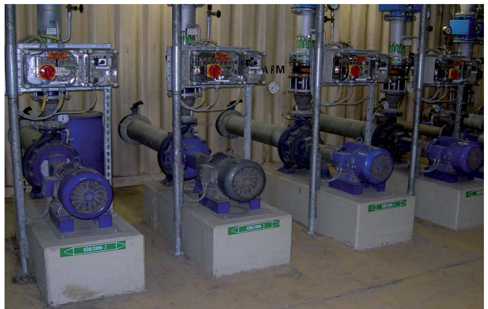
Zirkulationspumpen im Werk Mannheim der Unilever Deutschland GmbH.
