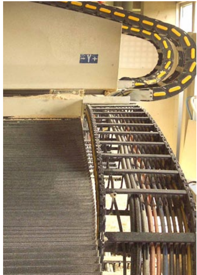
Energieführungskette in einer Bandförderanlage.
